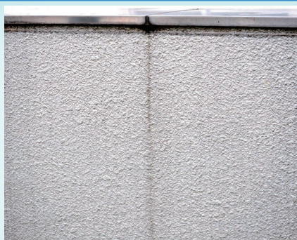
写真1 雨だれの汚れ
